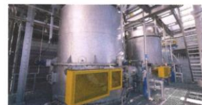
⑦ 炭化物ホッパ冷却器(多管式間接冷却) Carbide cooler (multi-tubular cooler) 下水汚泥炭化燃料(炭化物)を40℃まで間接冷却し安定化させます。 Carbonized sewage sludge fuel (carbide) is indirectly cooled to 40°C or lower to ensure stability.
