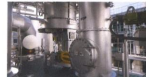
③ 炭化炉(循環流動床式炭化炉) Carbonizing furnace (circulating fluid-bed carbonizing furnace) 乾燥汚泥を500℃~550℃程度の温度の高温化で熱分解し、炭化物を生成します。 The dried sludge is pyrolyzed at a temperature of 500~550°C, turning into carbide.
