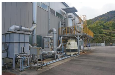
排ガス排水処理設備
